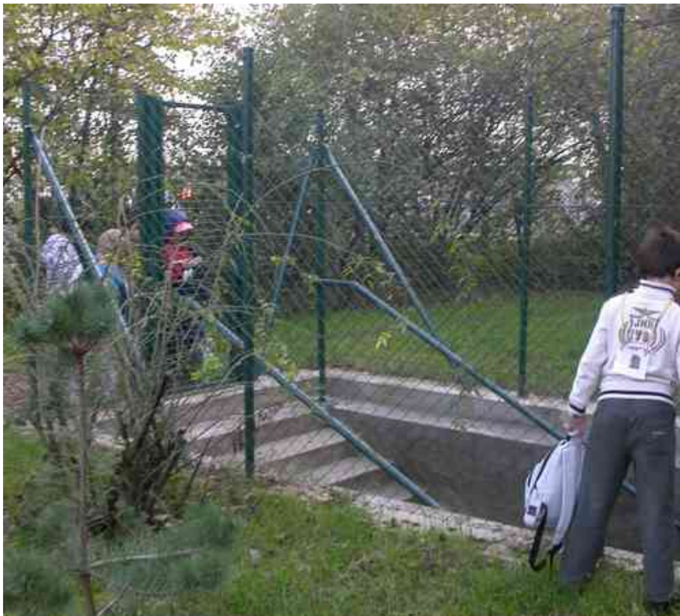
Sezione di 35 metri circa di recinzione in ferro verde, che ha subito un danno consistente, a causa di un incendio, in un'area adiacente al campo di calcio della scuola primaria via Marconi, Bresso, il 27 ottobre 2009.
